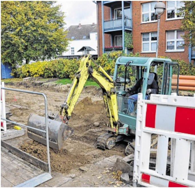
Christian Maaß verfüllt einen Hausanschluss-Graben in der Schulstraße in Laage. FOTO: REGINA MAI
